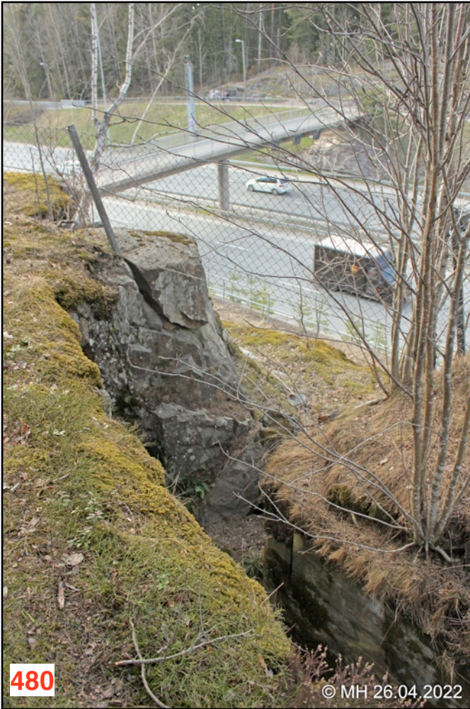
↑ Ampumahauta menettänyt etuseinän kehätien louhintojen yhteydessä.
