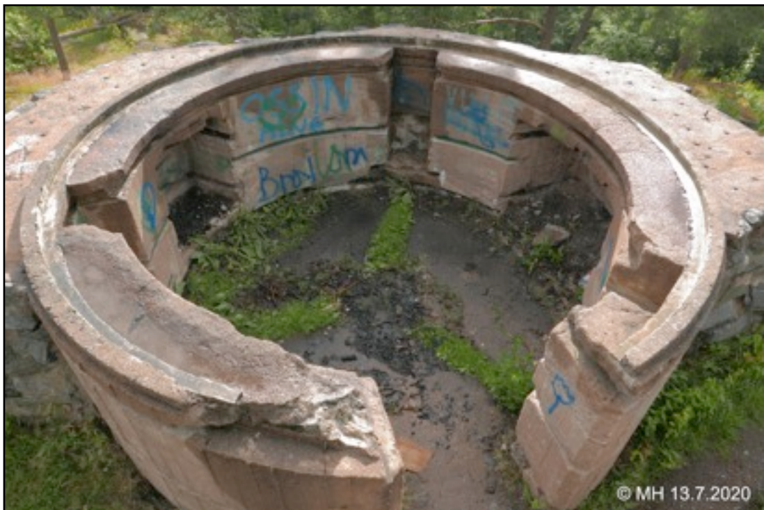
↑ Pohjoisempi konekivääriasema. Muurin päällä oleva betonirengas ylettyi oven yli, mutta on rikottu joskus 70-luvulla. En usko renkaan kuuluneen IT-patterin alkuperäiseen rakenteeseen.
